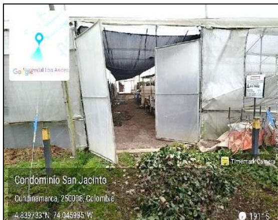
VISTA ÁREA REQUERIDA, INVERNADERO 1.
